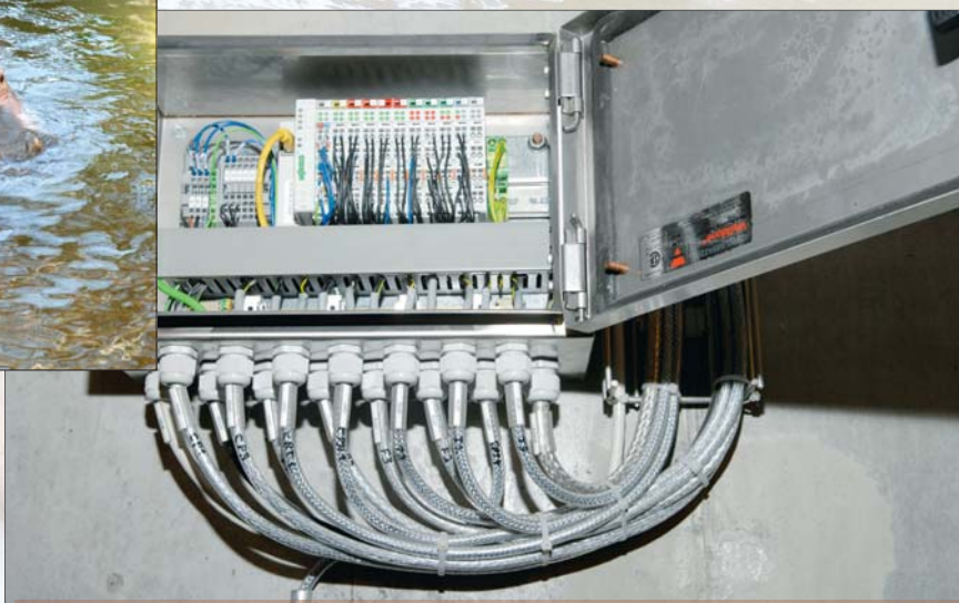
De decentrale enheder er også udstyret med Wago I/O moduler. Bemærk at alle kabler er skjærmede, også rene DC-kabler. Så kan eventuelle gnavnere ikke bide igennem dem.
